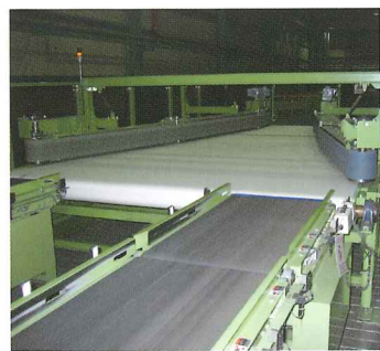
DC-I 物流センターのマーゴコンベヤ
